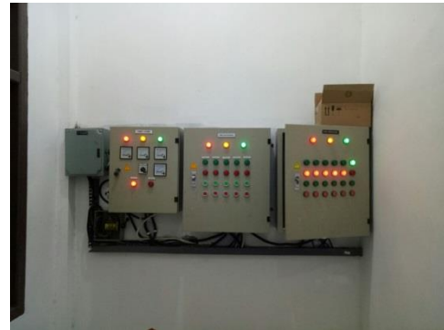
Gambar 2 Panel Kontrol yang terpasang pada mikro hidro di Instalasi Pengolahan Air (IPA) SPAM IKK Bacan
