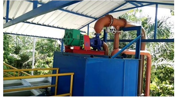
Gambar 1 Mikro hidro yang terdapat pada Instalasi Pengolahan Air (IPA) SPAM IKK Bacan
