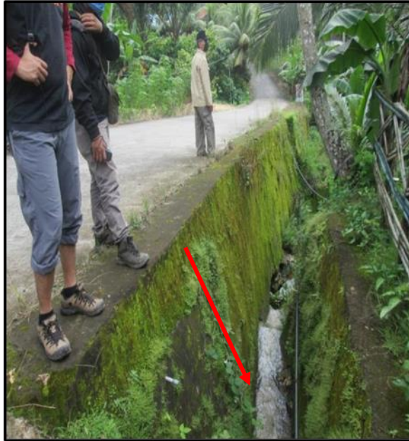
Gambar 6. Foto Selokan yang dalam akibat pernah terjadinya amblesan di area ini
