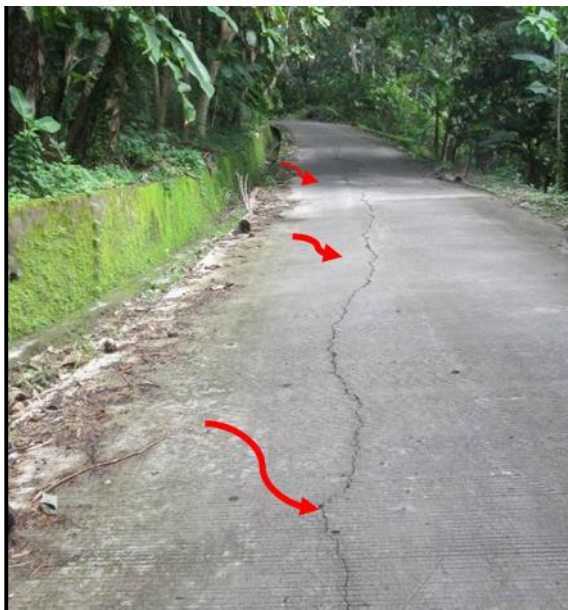
Gambar 8. Foto badan jalan (beton) yang sudah retak akibat dari adanya proses amblesan
