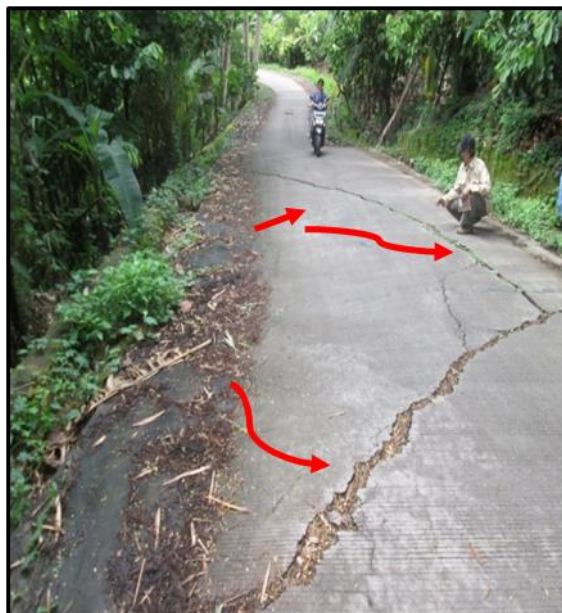
Gambar 7. Foto retakan pada pada badan jalan sebagai salah satu gejala adanya amblesan
