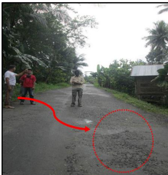
Gambar 9. Foto badan jalan (aspal) yang setiap musim hujan mengalami amblesan, tampak kondisi aspal yang mulai terjadi retak kecil (dilingkari)
