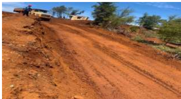
Gambar 5. Area Jalan Loading Point yang Curam (Dokumentasi Lapang, 2023)
