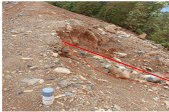
Gambar 3. Kondisi Longoran Lereng Patok 11
