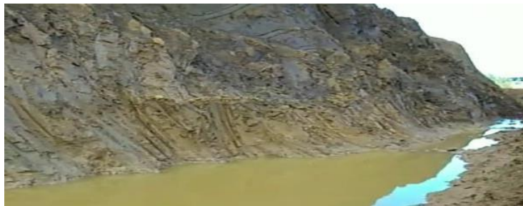
Gambar 13. Saluran Drainase Pit Raja Ampat
