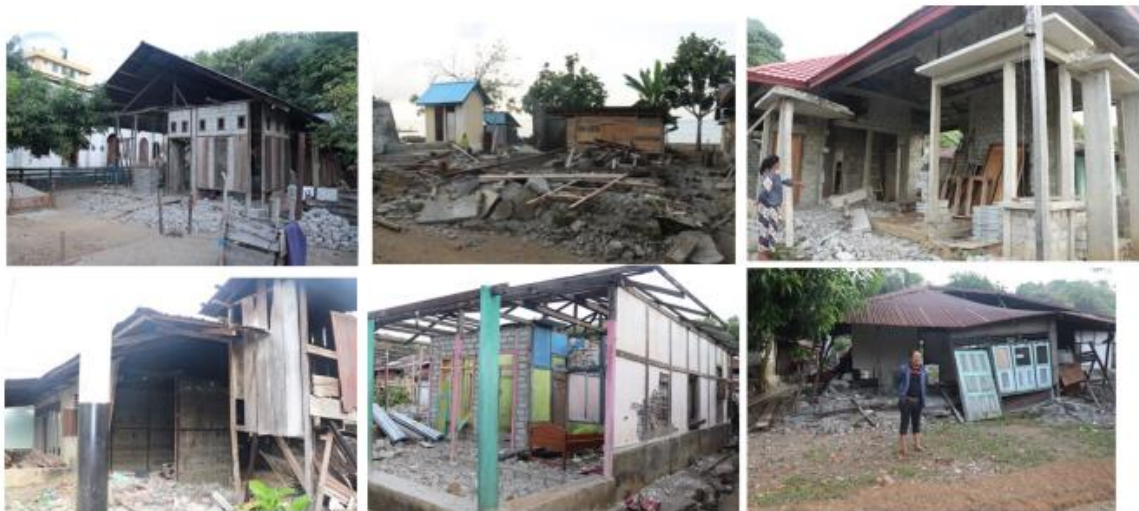
Gambar 3. Jenis Kerusakan Bangunan
