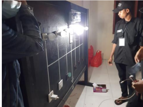
Gambar 5. Pemasangan empat saklar tunggal empat lampu, satu saklar seri dengan 2 lampu, dan stop kontak
