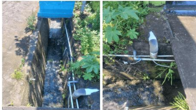
Gambar 4. Sanitasi Air Kotor ( Grey Water Dialirkan Ke Drainase Lingkungan) Kelurahan Tomalou (Sumber: Dokumentasi Pribadi, 2023)
