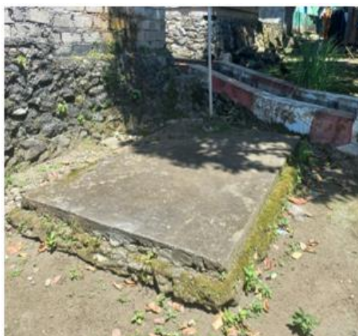
Gambar 7. Septick Tank untuk Limbah Rumah Tangga Black Water
