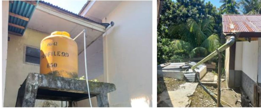
Gambar 8. Penampungan Air Hujan sebagai Sumber Air Bersih
