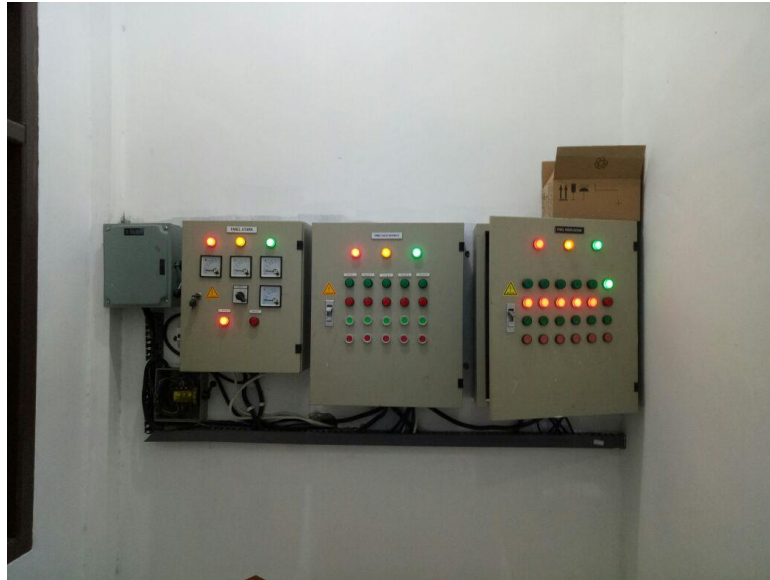
Gambar 2 Panel Kontrol yang terpasang pada mikro hidro di Instalasi Pengolahan Air (IPA) SPAM IKK
