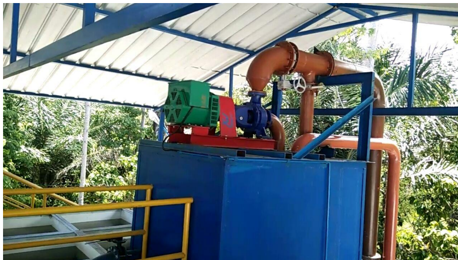
Gambar 1 Mikro hidro yang terdapat pada Instalasi Pengolahan Air (IPA) SPAM IKK Bacan
