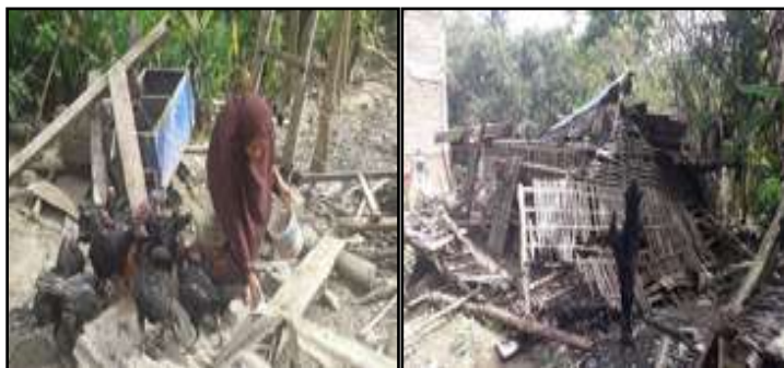
Gambar 1. Sistem pemeliharaan dan Kondisi lingkungan yang tidak layak
