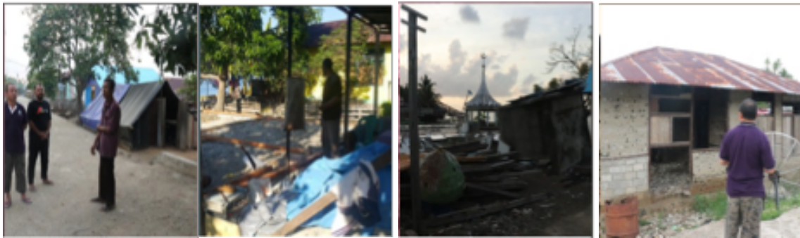
Gambar 5. Kegiatan Identifikasi Kerusakan Bangunan
