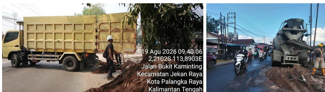
Gambar 3. (a) Tanah dan material tercecer di sekitar area pekerjaan; (b) kondisi akses masyarakat di sekitar proyek. Sumber: Dokumentasi lapangan (2026)
