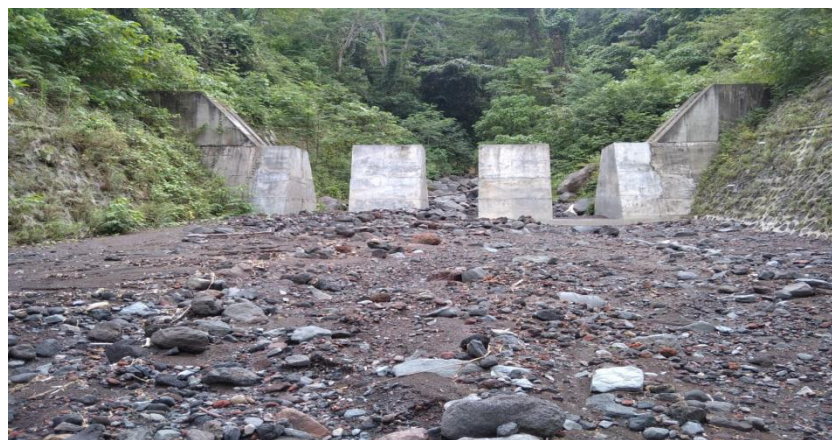
Gambar 1. Kondisi Sabodam sta. 02+600 yang penuh dengan material sedimen
